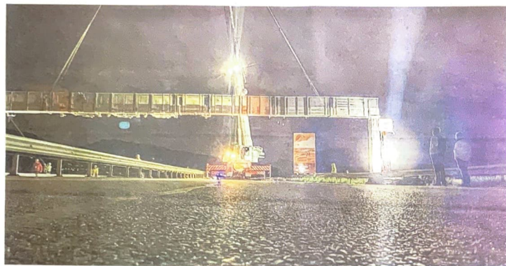
Le portique long de 37 mètres a été installé mercredi 5 mai, dans la soirée. Photos ATMB (ainsi que celle en Une)
